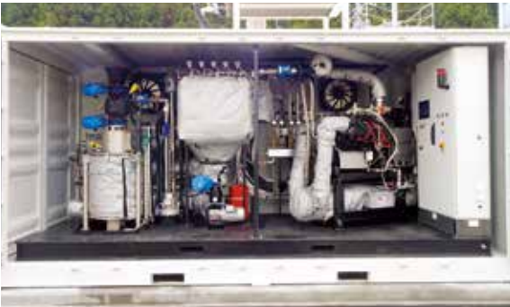
下西発電所プラント内
