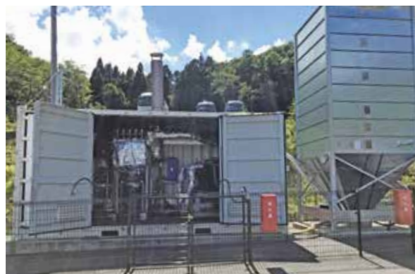
導入予定熱電併給システム(CHP)
