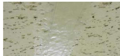
▲天井面の塗膜
