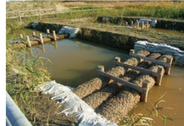
▲バイオログフィルター設置状況
