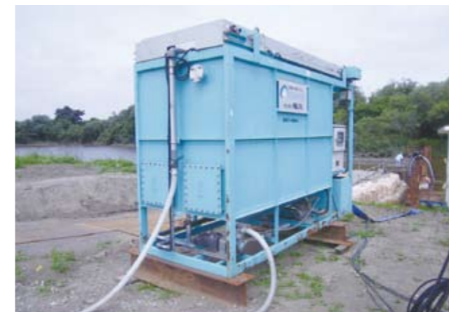
▲濁水処理機(処理能力10m 3 /h)
