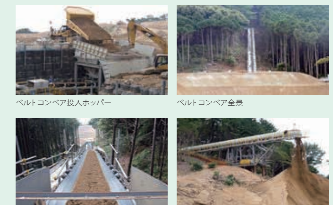
ベルトコンベア稼働状況
