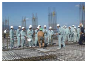
松江工業高校2年生35名を招いての現場見学会。Brillia琵琶湖大津京BEACH & RESIDENCE新築工事(滋賀県大津市)
