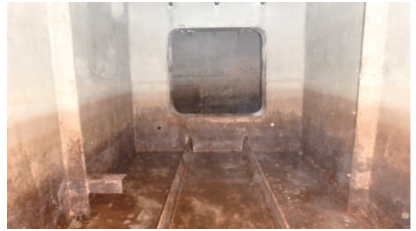
図4 鋼製基礎内部の腐食状況
