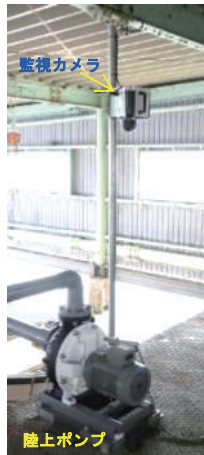
写真5 陸上ポンプと監視カメラ
