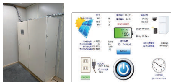
写真8 蓄電池設置状況と発電モニタリング画面
