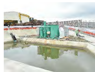
写真10 沈砂池および濁水処理設備
