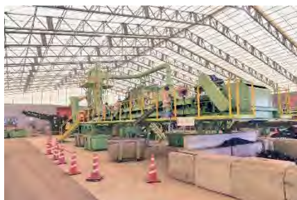
写真4 解体残渣選別設備
