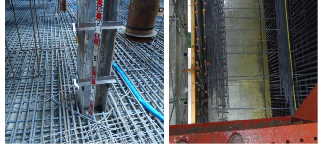
写真 4 温度センサ取付状況 (左:ごみピット耐圧盤、右:ごみピット壁)
