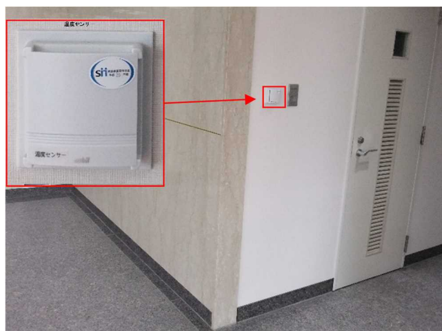
写真3 エントランスホール温度センサー設置位置
