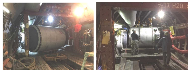
(推進管回転・揚重作業時) (推進管移動・セット時) 写真5 坑内揚重作業状況
