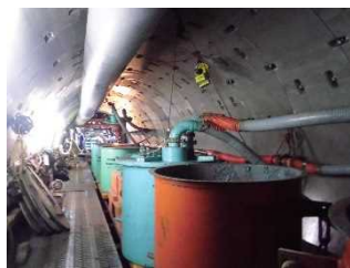
写真7 坑内排泥タンク
