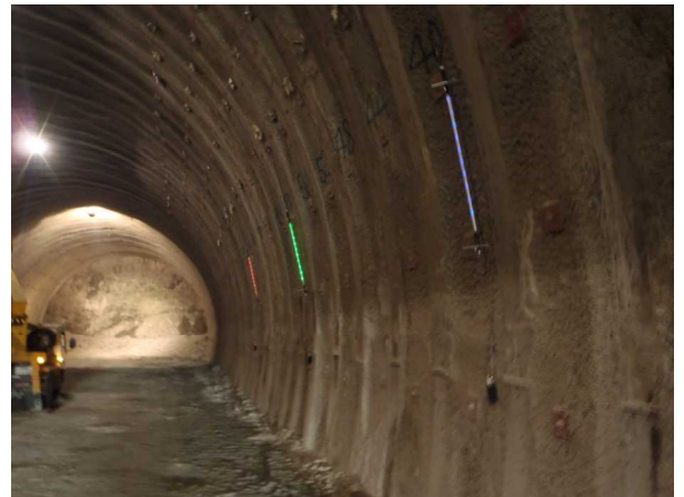
写真9 光る変位計設置状況（下り線干渉部） 3)
