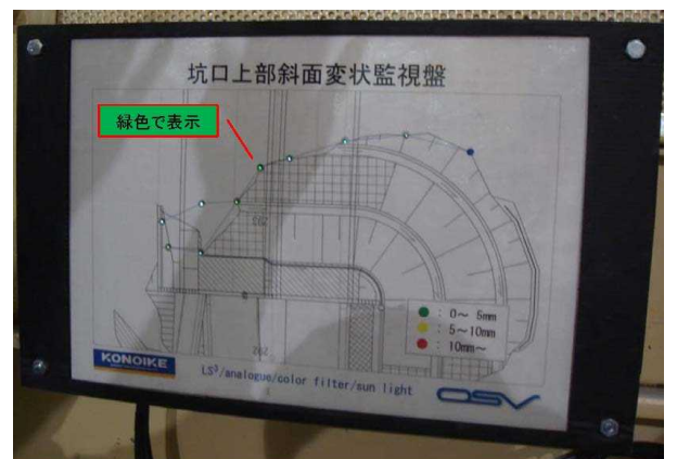
写真8 「M」表示板（防音ハウス内に設置）
