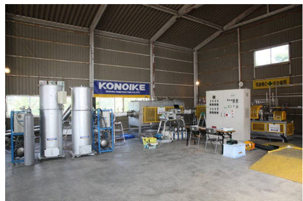
写真 3 実証試験装置全景
