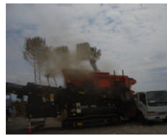
写真 6 粉じん発生状況(生石灰)
