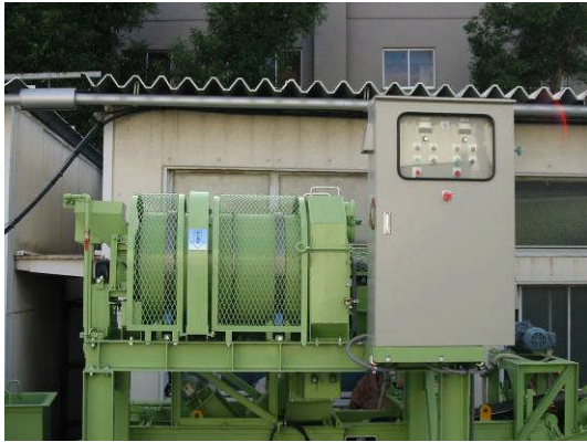
写真 1 ロータリー式土壌洗浄機
