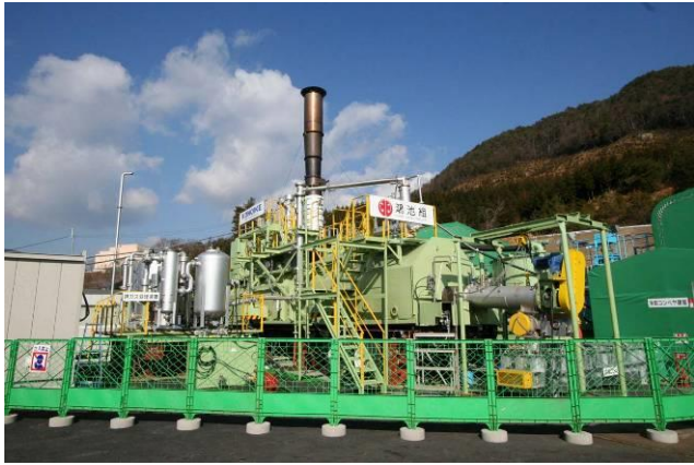
間接熱脱着設備実機 全景
