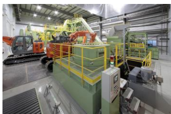
写真4 フレキシブルコンテナ破袋機
