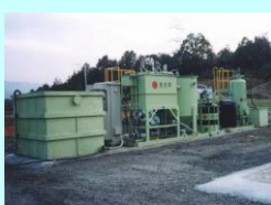
廃水処理設備
