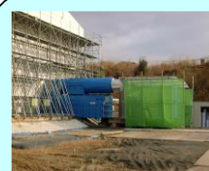
集塵換気設備
