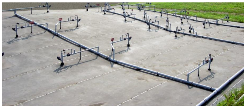
地上部での配管
