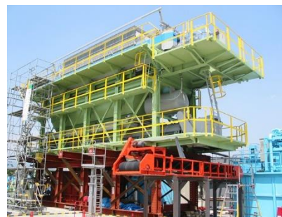
高圧薄層脱水システム(対象:底泥)
