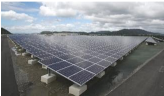
再生可能エネルギー(太陽光発電)
