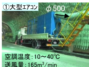
【①大型エアコン】
