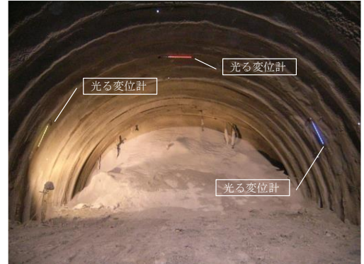
写真-1 穂別トンネル西工事（光る変位計）
