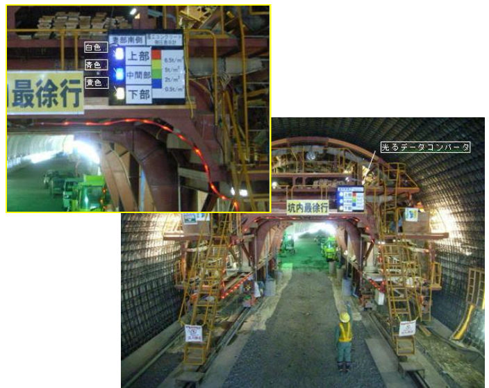
写真-3 佐野東工事出流原トンネル（光るデータコンバータ）
